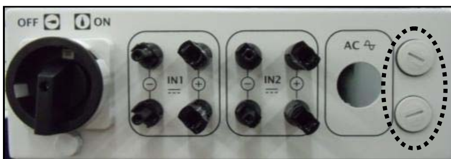
Fig. 23 - Passaggio cavi per connessione RS-485
